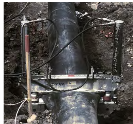
Blockerad PE400 avloppsledning.
