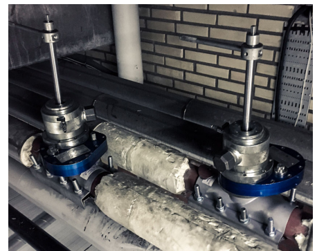
Blockering med DN80-verktyg på kyla i Helsingborg.
