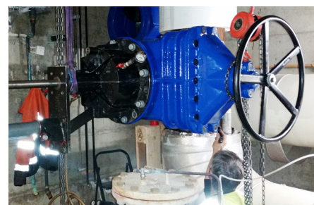
Anbörning kyla DN400, Helsingborgs lasarett.
