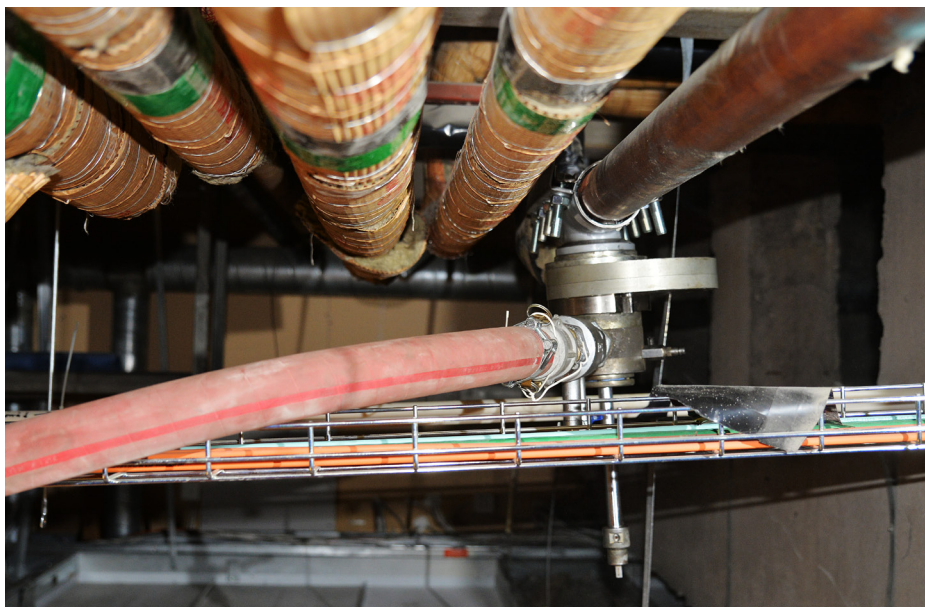
Proco Services blockeringsverktyg med inkopplad bypass.
