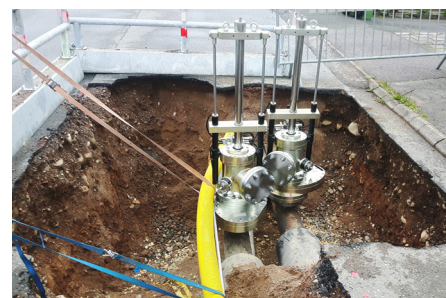
Blockering på fjärrvärme under vintersäsong.
